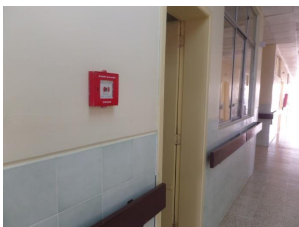
Figura 29: Señalización del servicio
