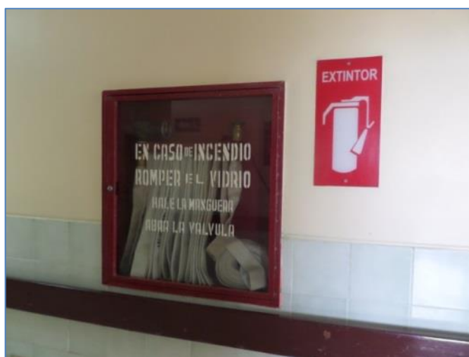
Figura 5: señalización del servicio
