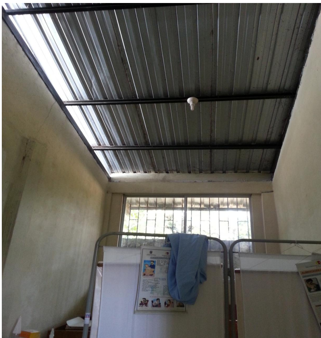
Figura 19. Sala de Parto en pésimas condiciones
