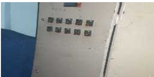
Fotografía N° 22: Caja de brakes, donde se controla Iluminación y focos, sin señalética
