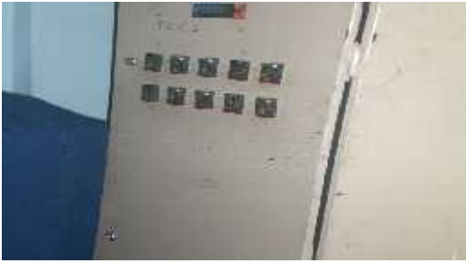
Fotografía 14: Caja de brakes, donde se controla iluminación y focos, sin señalética
