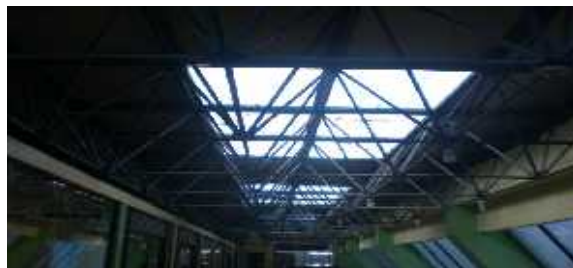
Fotografía 28: Techos, en esta área 1% de goteras
