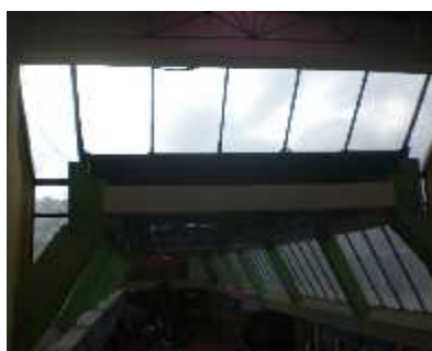
Fotografía 12: ventanales sin protecciones
