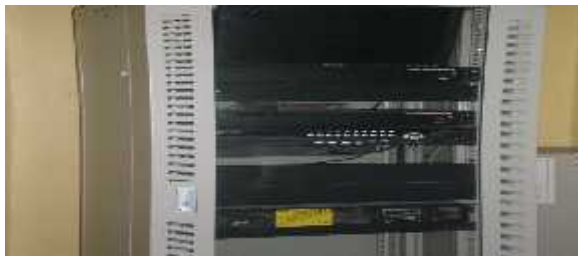
Fotografía N°37: Elemento eléctrico donde se controlan Cámaras.
