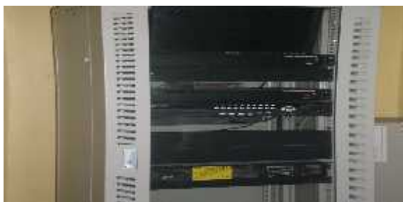
Fotografía 29: Elemento eléctrico donde se controlan Cámaras.
