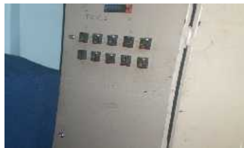
Fotografía 19: Caja de brakers, sin señalética
