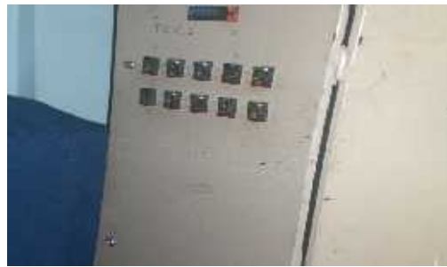
Fotografía N° 27: Caja de brakers, sin señalética
