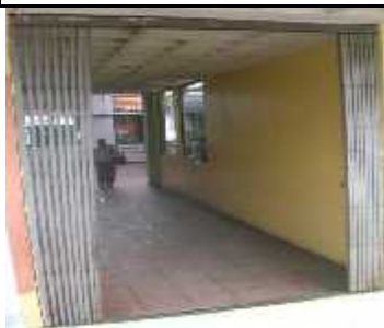
Fotografía 6: Ruta de salida libre de obstrucción. Sin señalización
