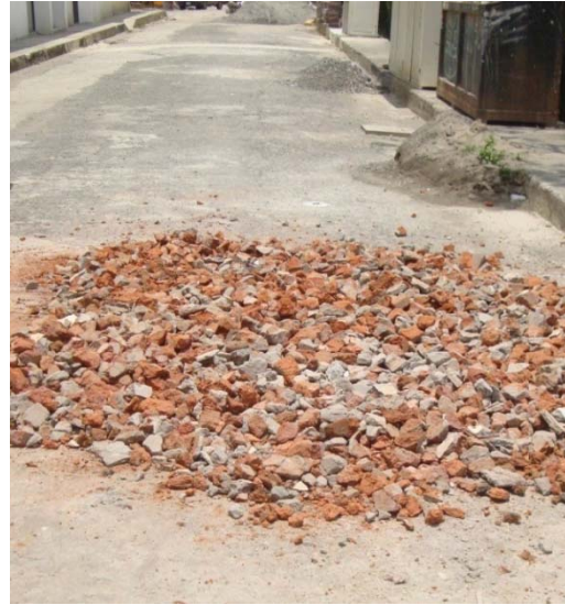
Fotografía N° 27. Cascote de ladrillo disgregado en pedazos más pequeños.
