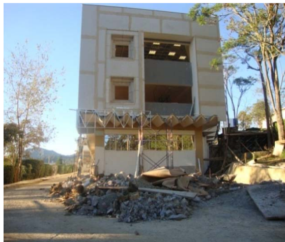
Fotografía N° 6 Remodelación de uno de los edificios de la UTPL. Se generó más de 1300 m3 de escombros.
