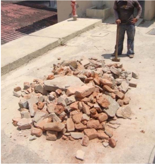
Fotografía N° 26. Cascote de ladrillo del tamaño como se lo encuentra en las escombreras.
