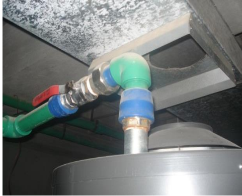
Figura 2.8. Tubería CPVC instalada para transporte de ACS a las habitaciones. Fuente: Fotografía de los autores.
