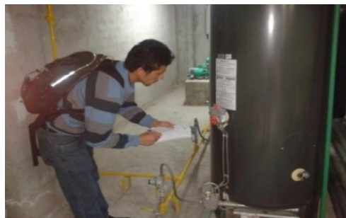
Figura 2.3. Registro de las características técnicas del termo-tanque.
