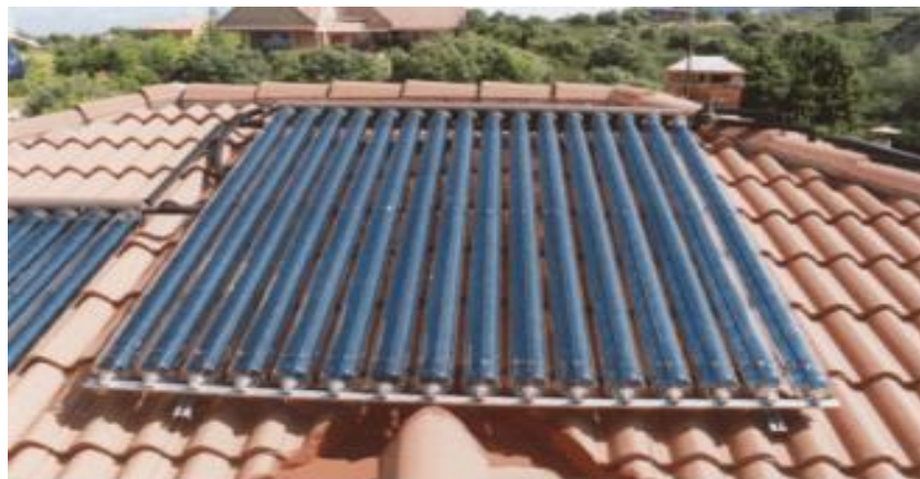
Figura 5.8. Foto colector solar de tubo de vacío tipo heat pipe.
