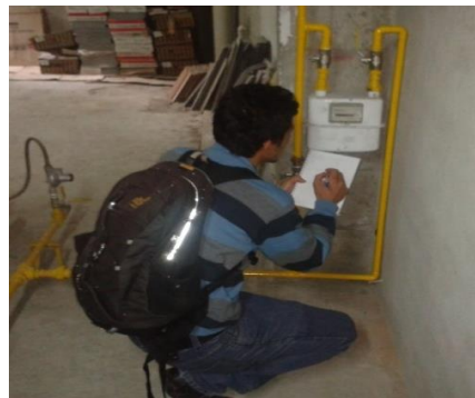
Figura 2.6. Medidor de consumo de GLP en la provisión de ACS a las habitaciones del hotel. Fuente: Fotografía de los autores.
