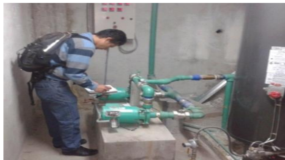
Figura 2.4. Registro de las características técnicas de las bombas de recirculación de ACS.
