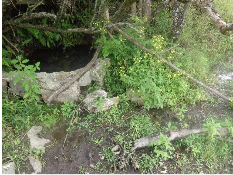
Fotografía 4. 14 Escape de agua de reservorio del MI-33. Fuente: Abarca, 2014.
