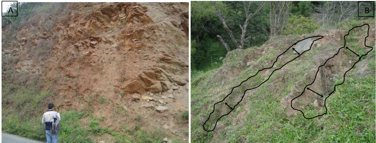
Fotografía 4. 8 Meteorización de los materiales. A) Oxidaciones en la Unidad Chiguinda, MI-05. B) Agrietamiento de suelos limosos de la Fm. Santo Domingo, MI-10. Fuente: Abarca, 2014.
