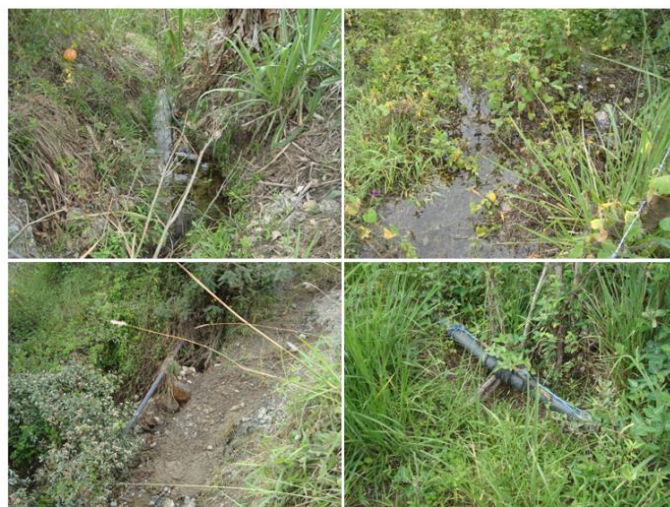
Foto 4. 18 Escapes de aguas de tuberías, ocasionando una saturación de los suelos. Fuente: Carrillo, 2014.
