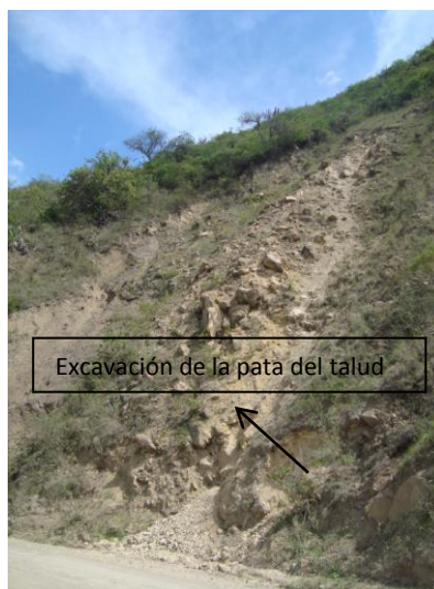
Foto 4. 11 Excavación del pie del talud (ML-12) sobre la Formación Loma Blanca. Fuente: Carrillo, 2014.
