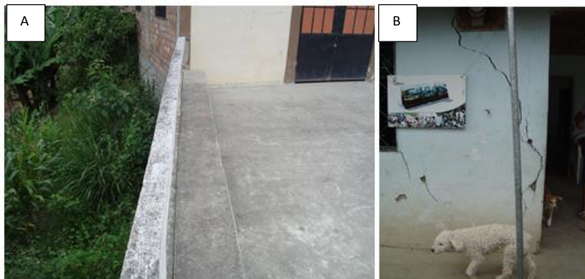
Foto 4. 16 Problemas causados. A) Inclinación de muro principal. B) Fisuras y cuarteo de las paredes. Fuente: Carrillo, 2014.
