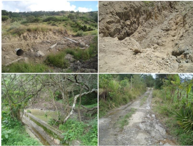
Foto 4. 17 Mantenimiento deficiente del sistema de drenaje. Fuente: Carrillo, 2014.
