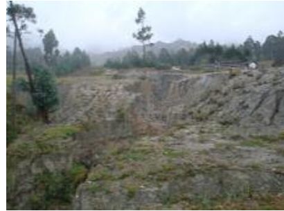
EROSIÓN EN CÁRCAVS SEVERA Y REPTACIÓN EN LA URB. DE PROFESORES DE U.N.L
