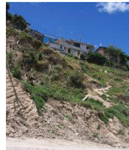
DESLIZAMIENTO EN EL Km1 VIA A ZAMORA
