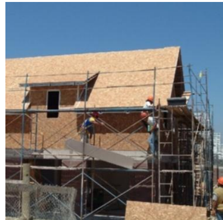
FIGURA 6: UN TECHO FABRICADO CON PANELES OSB
