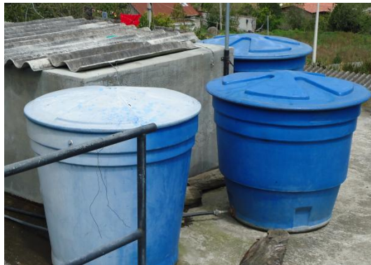
Figura 18: Tanques de almacenamiento de agua Fuente: Granja Avícola "GALARRAGA"
