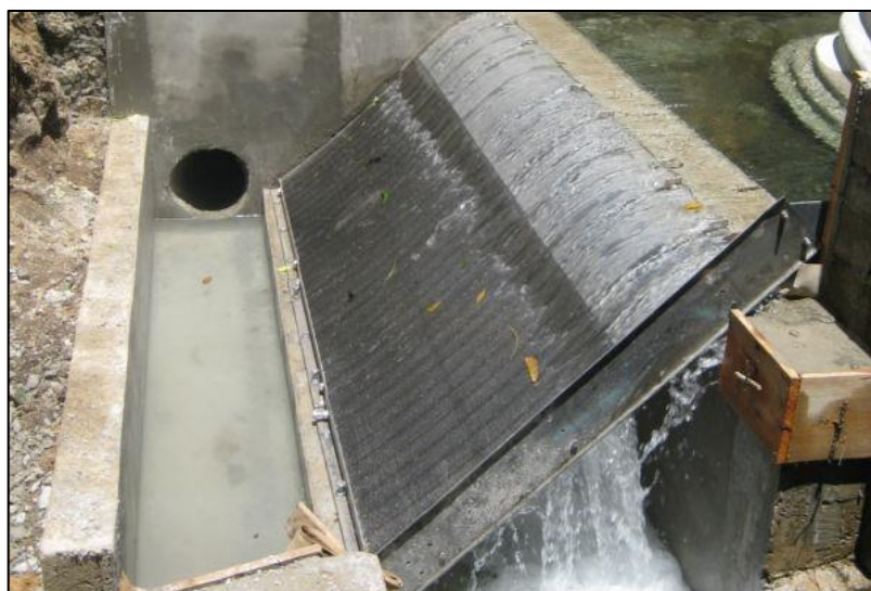
Foto 1-1: Rejilla Coanda en Guatemala
