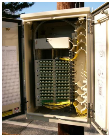
Figura 1. 14. Armario óptico Fuente: [13]
