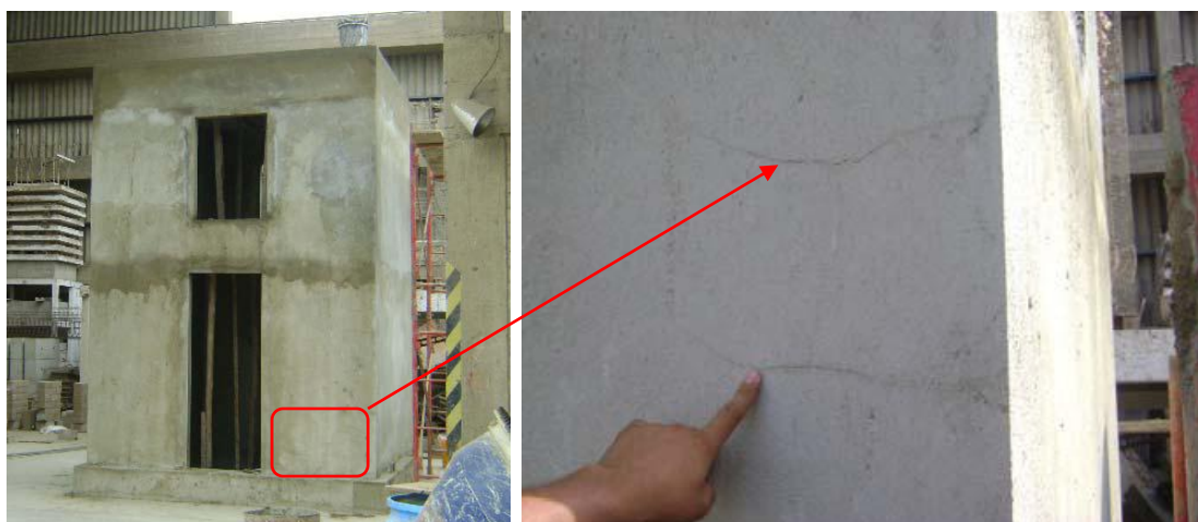
Grafico 20 Fisuras en las caras exteriores de los paneles
