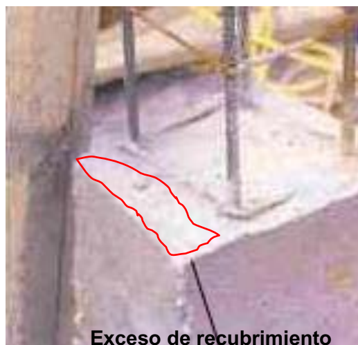
Grafico 56 Colocación errónea del encofrado-falta de separadores
