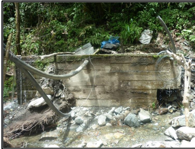
Figura 5. Desarenador Fuente: El Autor
