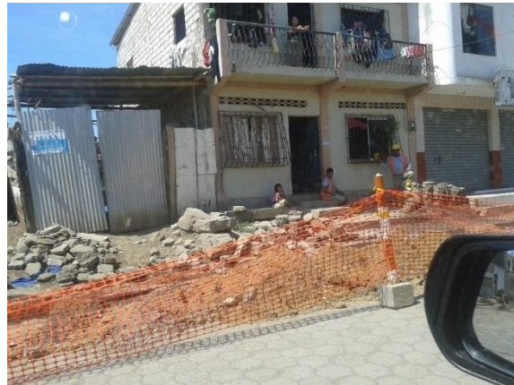
Fotografía No. 8 Arreglos de calles en mal estado.
