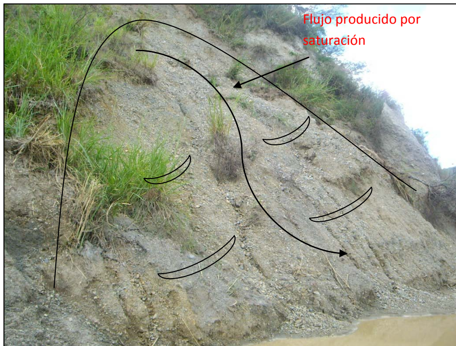
Foto No. 30: Deslizamiento tipo Flujo producido por saturación del terreno
