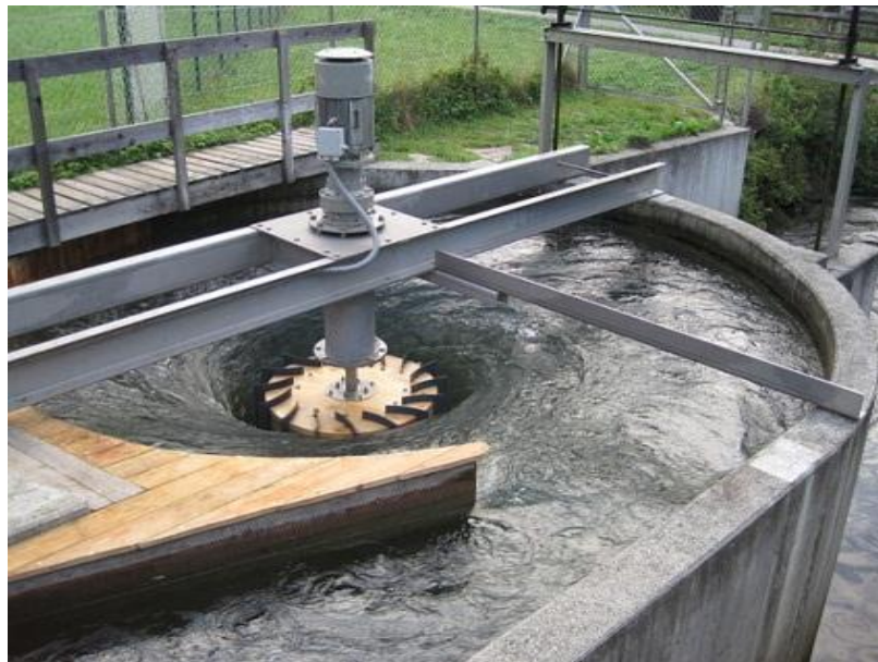
Figura 2.8. Microcentral hidroeléctrica basada en vórtice gravitacional
