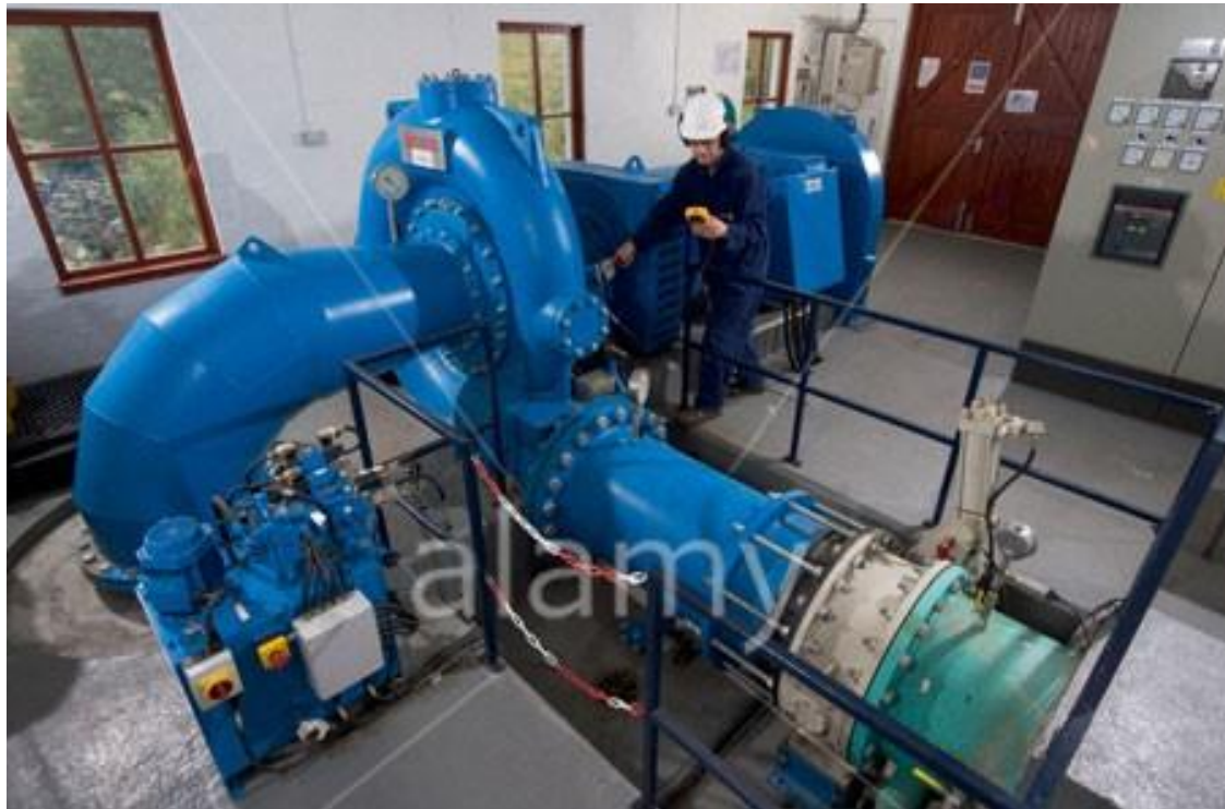
Figura 2.5. Microcentral hidroeléctrica equipada con una turbina Francis
