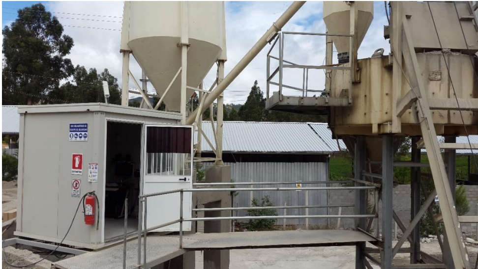
Imagen 6. Cabina de control Fuente: Hormi - Center Elaborado por: Autor
