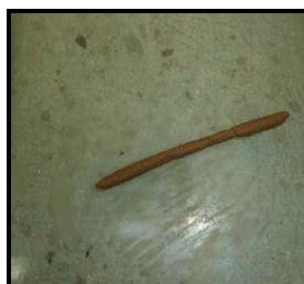
Figura 3.18 Fisuramiento de material. Fuente: La autora.
