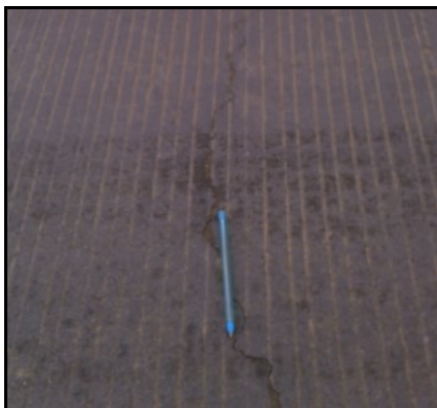
Figura 21. Grieta de durabilidad "D" de severidad baja (Vía Loja - Zamora). (Abscisa 6+715.80)
