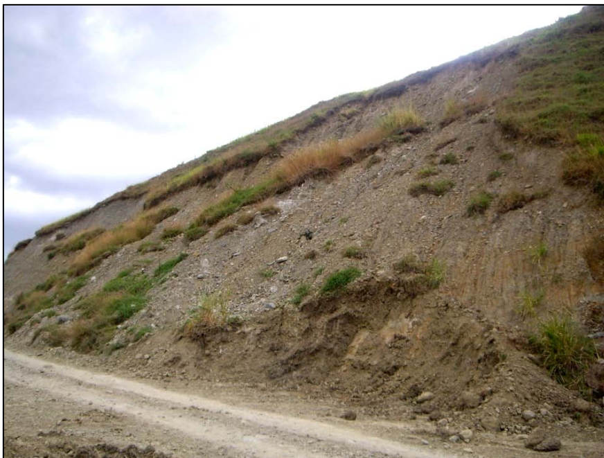
Foto No. 29: Suelos residuales afectados por la pendiente y poca adhesión de sus partículas
