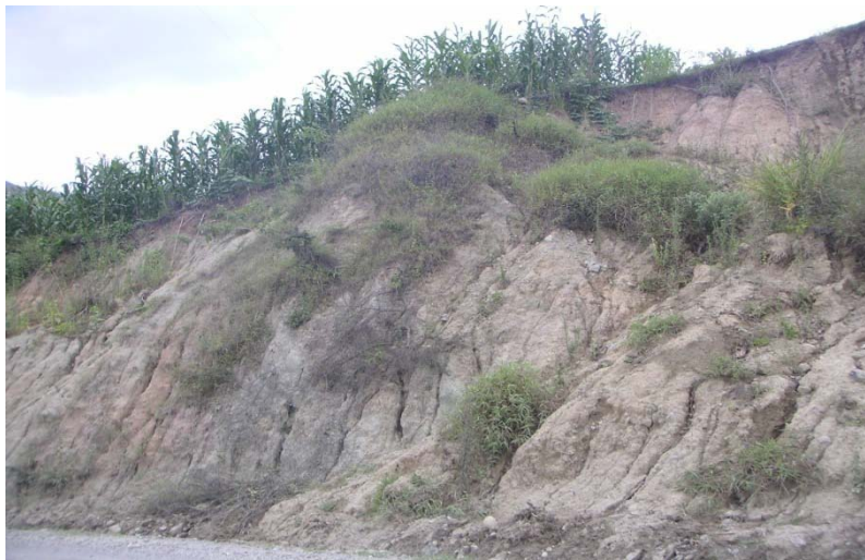
Foto 28: Suelos afectados por la pendiente y poca adhesión de sus partículas
