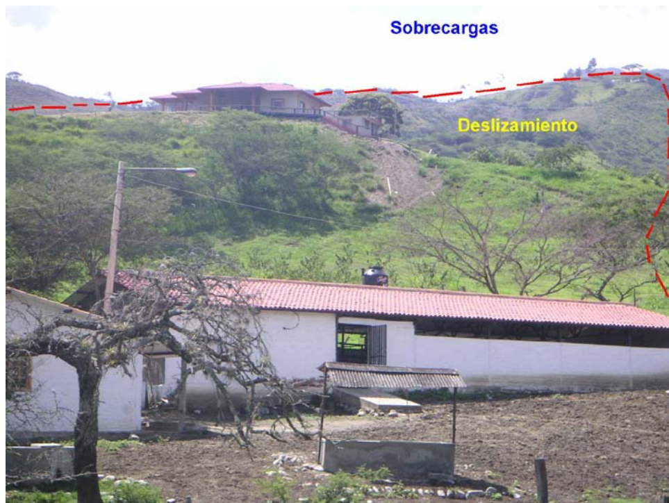
Foto 30: Deslizamiento producido por carga en la corona
