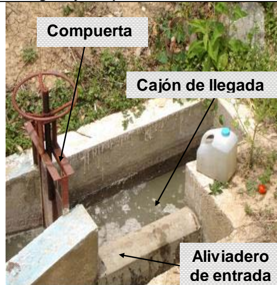
Figura 10.1. Estructuras de tratamiento preliminar: Cajón de llegada y compuerta.
