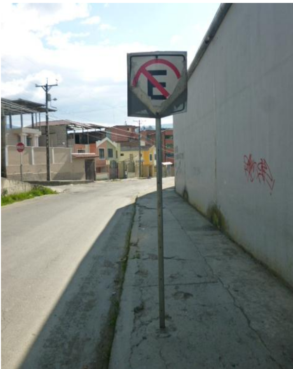
Figura 3.6. Señal vertical destruida ubicada en Av. Salvador Bustamante Celi y Agustín Carrión Palacios. Fuente y elaboración: El autor
