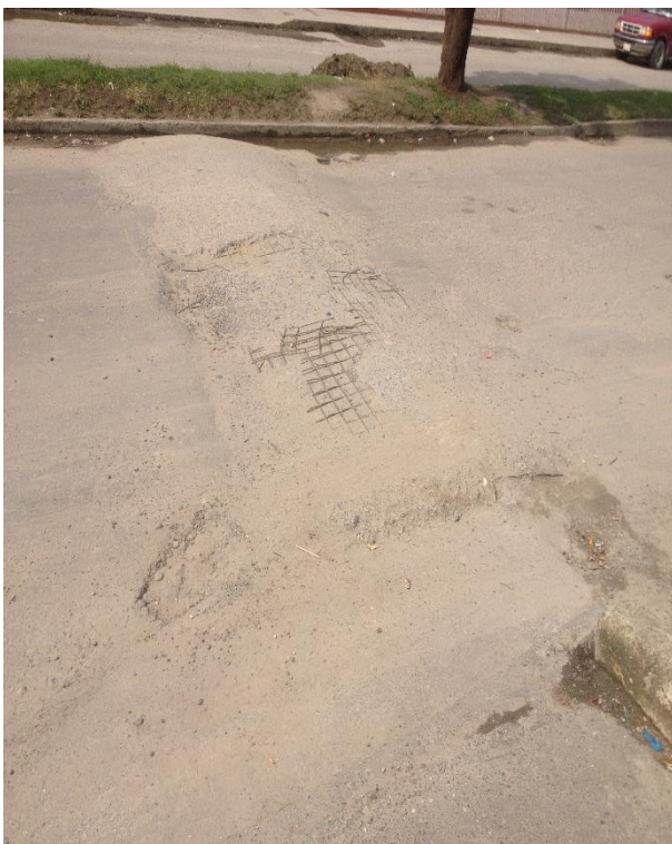
Figura 3.12. Señal horizontal (Rompe de Velocidades) en mal estado en la Av. Salvador Bustamante Celi. Fuente y elaboración: El autor
