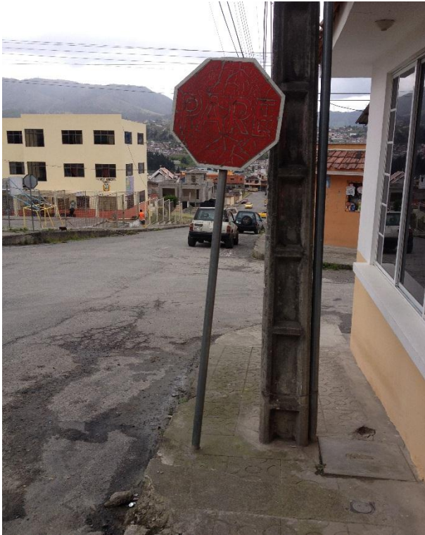
Figura 3.11. Señal vertical deteriorada e ilegible ubicada en las calles Arupos y Cedros. Fuente y elaboración: El autor
