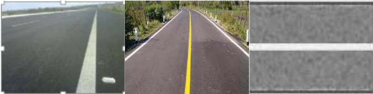
Figura 2.19. Señales sobre la calzada – línea continua.
