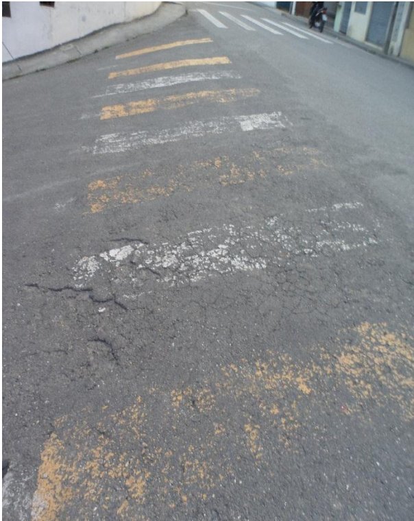
Figura 3.13. Señal horizontal deteriorada ubicada en las calles Av. De Los Paltas y Nicolasa Jurado. Fuente y elaboración: El autor
