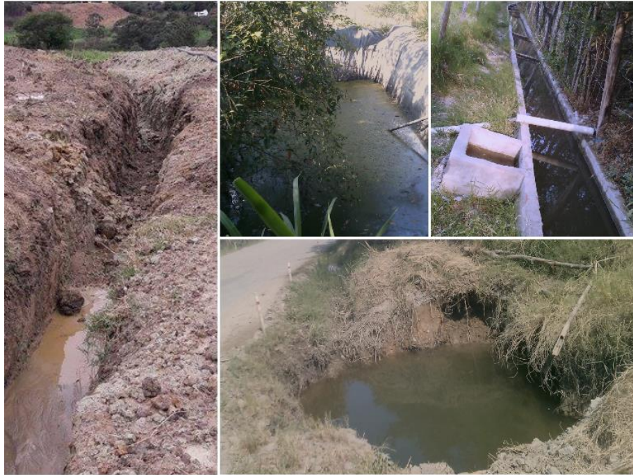
Foto 18. Medios Antrópicos causantes de la desestabilización del deslizamiento. Fuente: La Autora.
