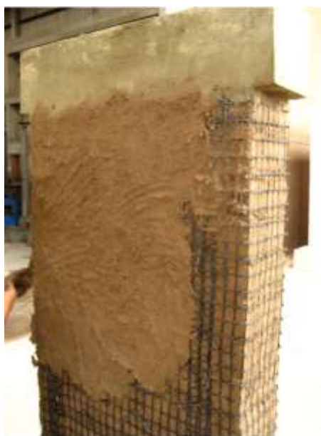
Figura 37: Muro de adobe reforzado con geomalla Fuente: Solís et al. (2015)
