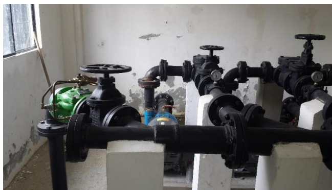
Figura 7. Estación de bombeo “La pradera” GAD Loja
