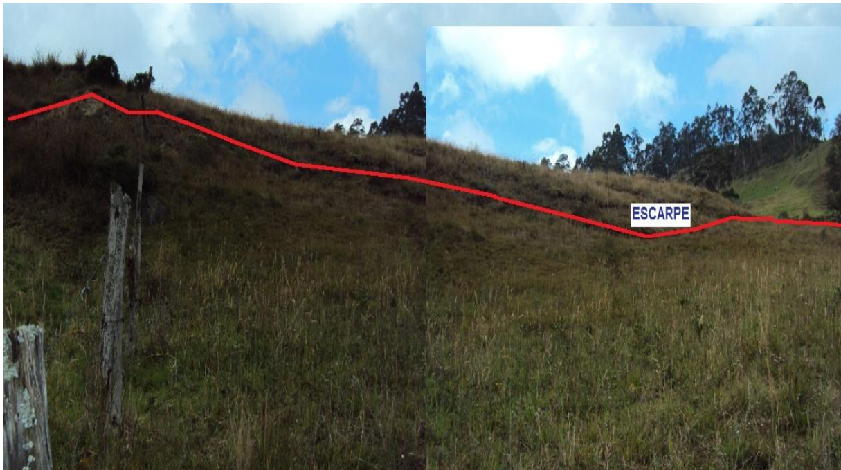
Figura A.1.2: Talud Chirimoyo, parte derecha
