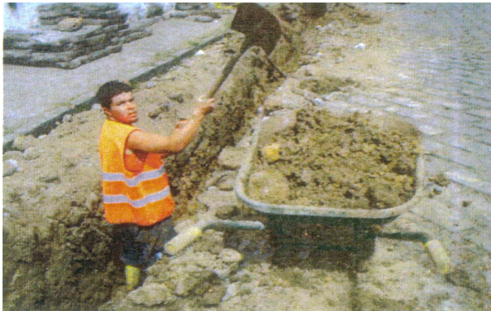
Foto No. 4 Trabajadores realizando instalación de matriz para el suministro de agua no tratada.
