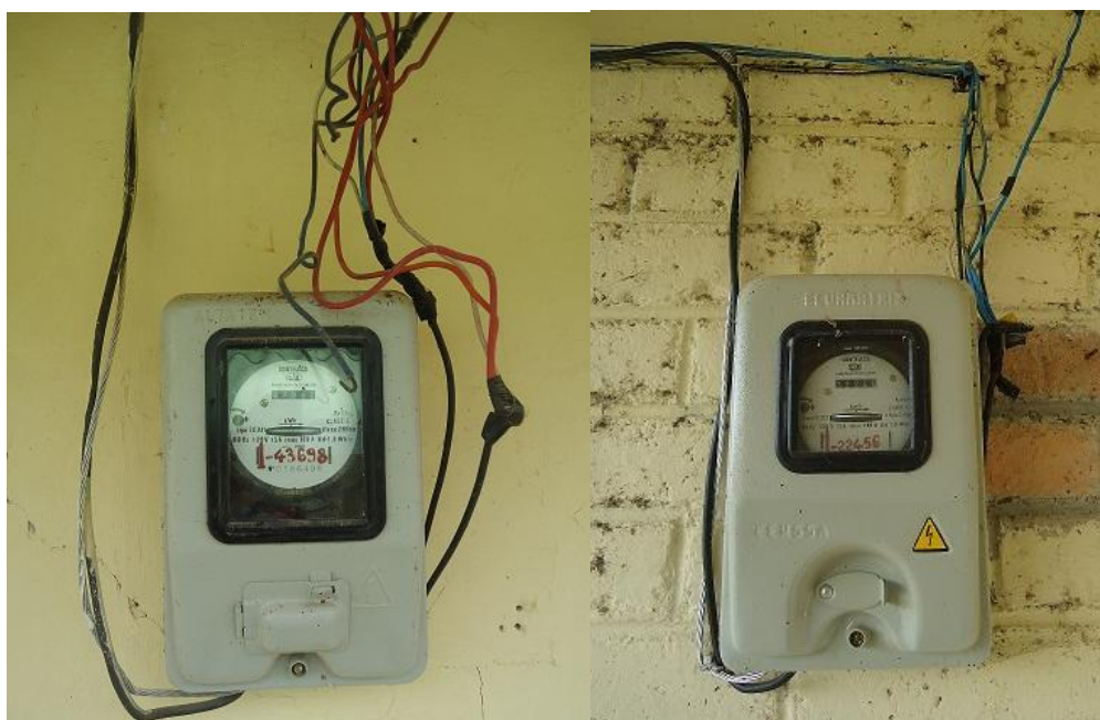
Imagen.6.12 Estado de sistema eléctrico. SC Selva Alegre y Manú
