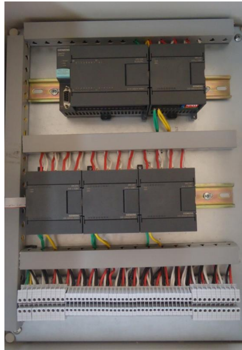
Figura 3.3. Fotografía del panel de control ya terminado.
