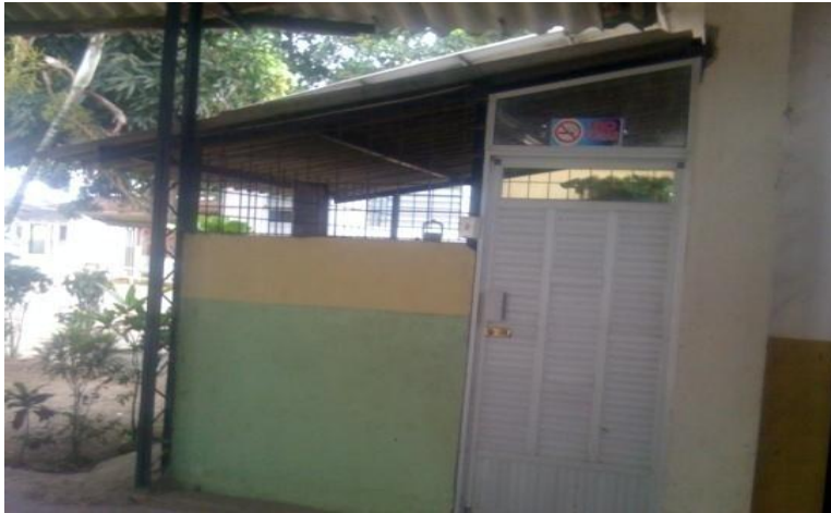
ZONA DE SEGURIDAD EXTERIOR PARA ALAMACENAMIENTO DE TANQUES DE OXÍGENO
