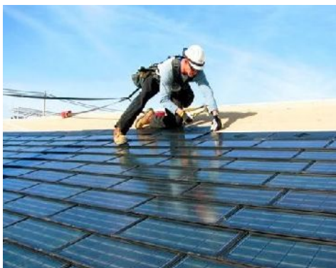
Fig. 5. Paneles solares en la azotea de un edificio.
