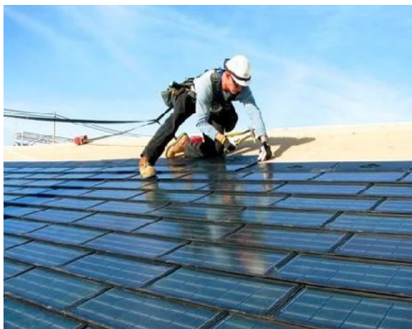
Fig. 2.5. Paneles solares en la azotea de un edificio.
