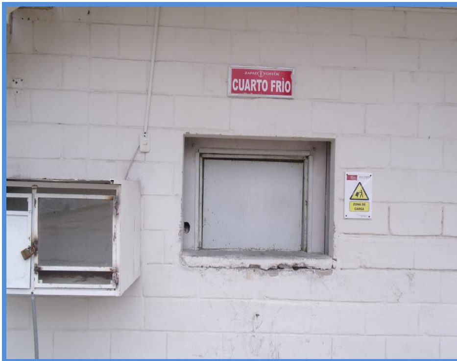
Fotografía Nº 13: Cuarto frío de Zapad
