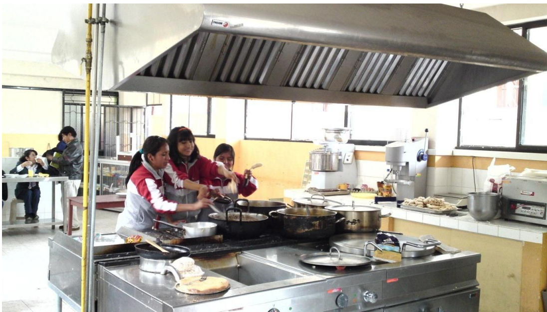
Equipamiento para la especialidad de Cocina del Colegio Técnico “Alfonso Lituma Correa”
