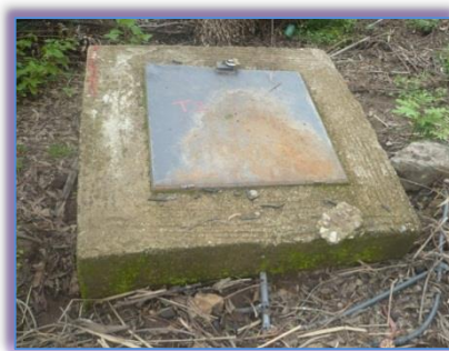
Imagen 1.6 Tanque de distribución
