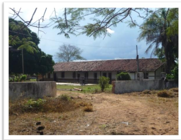
Ilustración 15. Fachada en estado de deterioro
