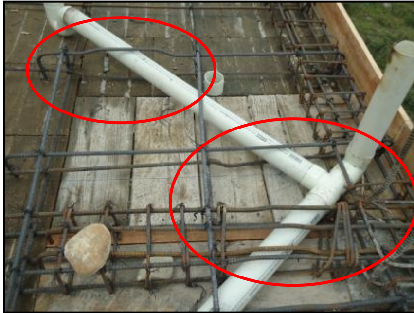
Figura 1.48 Colocación inadecuada de ductos y tuberías en vigas
