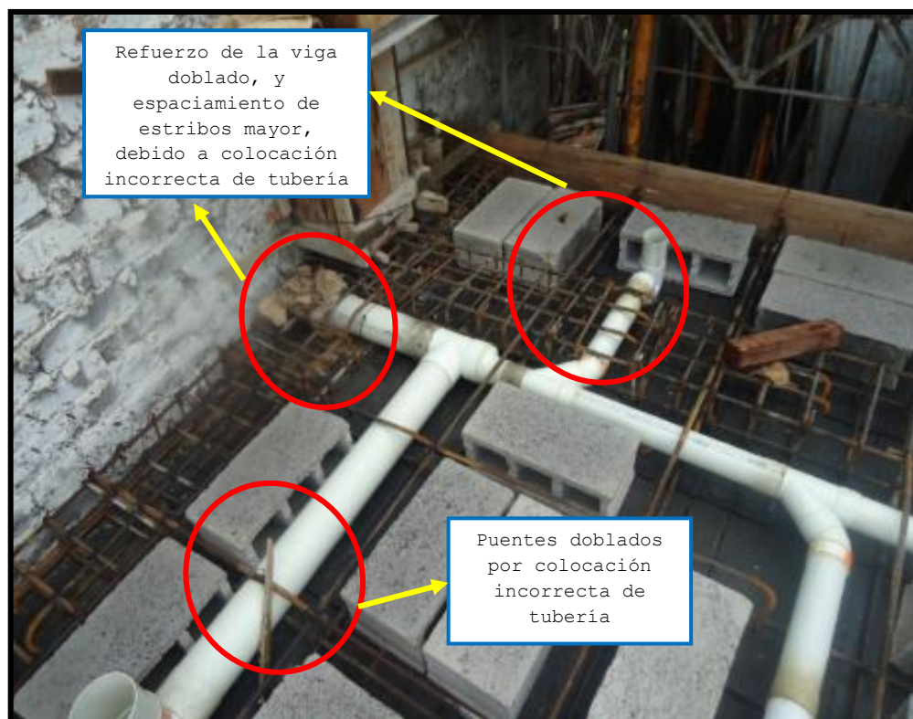
Fot. 3.42 Colocación errónea de tuberías que modifican la colocación y forma del acero de refuerzo y desplazan a los estribos a espaciamientos mayores, incumplimiento de: (Numerales 6.3.12, y 21.3.4.2 del código ACI 318-08) Fecha de captura: 31/01/2011
