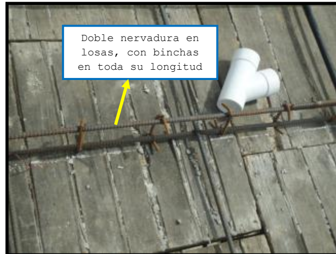
Fot. 3.58 Nervio con doble refuerzo y binchas en toda su longitud Fecha de captura: 06/01/2011
