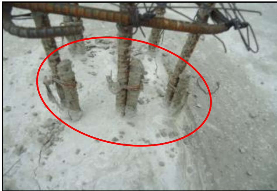
Figura 1.57 Longitud escasa de empalme por traslapado en columnas
