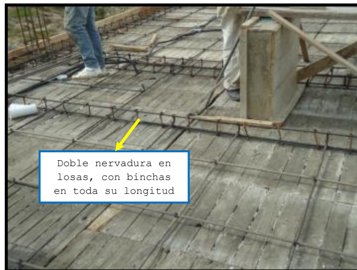
Fot. 3.59 Nervio con doble refuerzo y binchas en toda su longitud Fecha de captura: 06/01/2011
