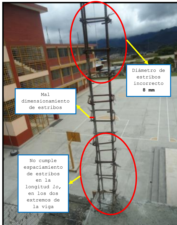
Fot. 3.50 No cumple espaciamiento y diámetro del refuerzo transversal en columnas (Numeral 21.3.5.2 y 7.10.5.1 del código ACI 318-08) Fecha de captura: 29/12/2010
