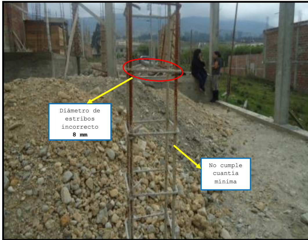
Fot. 3.9 No cumple área del refuerzo longitudinal y diámetro de estribo (Numeral 21.6.3 y 7.10.5.1 del código ACI 318-08)
