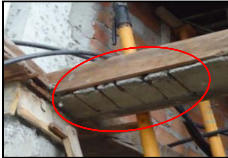
Figura 1.50 Falta de recubrimiento en vigas
