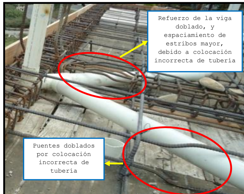
Fot. 3.12 Colocación errónea de tuberías que modifican la forma y posición del acero de refuerzo, incumplimiento de: (Numeral 6.3.12 y 21.3.4.2 del código ACI 318-08)
