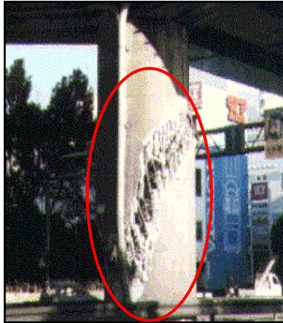
Figura 1.43 Falla por tensión diagonal
