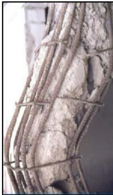
Figura 1.45 Falla en columna a causa de estribos abiertos
