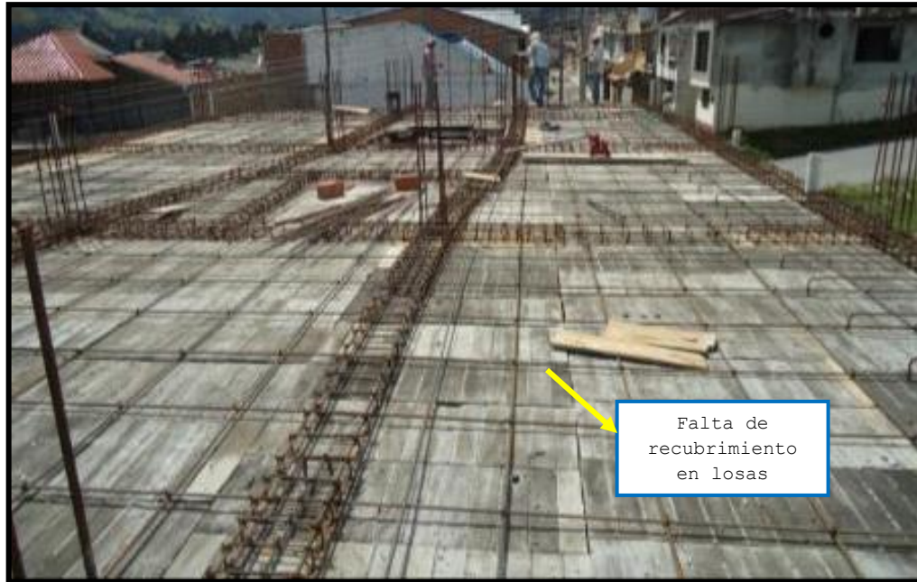
Fot. 3.32 Refuerzo de la losa sin recubrimiento, incumplimiento de: (Numeral 7.7.1 del código ACI 318-08 Fecha de captura: 13/12/2010
