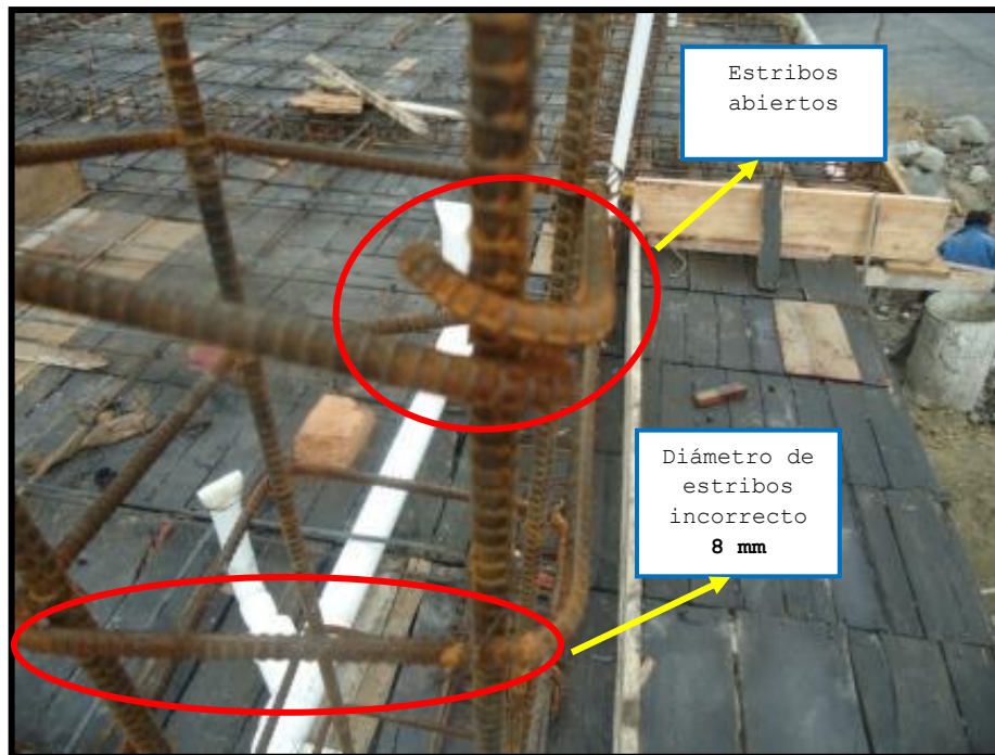
Fot.3.49 Extensión del gancho del estribo y diámetro insuficiente, incumplimiento de: (Numeral 7.1.3 literal (c) y 7.10.5.1 del código ACI 318-08) Fecha de captura: 01/02/2011
