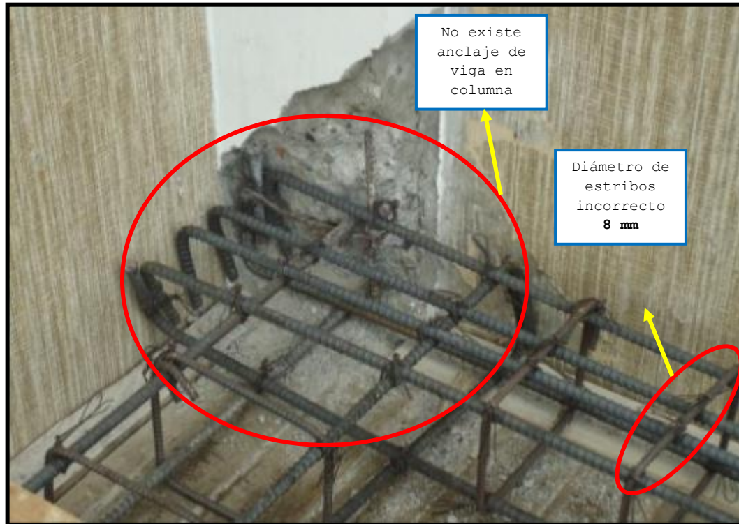
Fot. 3.52 Anclaje de viga en columna erróneo, diámetro de estribos incorrecto, incumplimiento de: (Numeral 12.5.1 y 7.10.5.1 del código ACI 318-08) Fecha de captura: 27/01/2011
