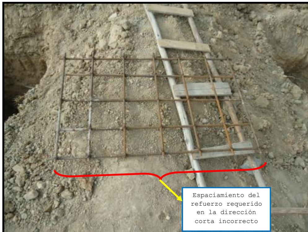
Fot. 3.10 "Zapata rectangular" no cumple con espaciamiento del refuerzo en la dirección corta (Numeral 15.4.4.2 del código ACI 318-08 Fecha de captura: 08/12/2010
