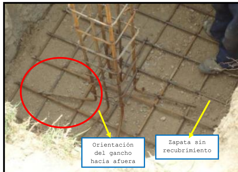
Fot.3.18 No cumple recubrimiento y orientación del gancho del refuerzo longitudinal de la columna cerca del fondo de la cimentación (Numeral 7.7.1 literal (a) y 21.12.2.2 del código ACI 318-08)
