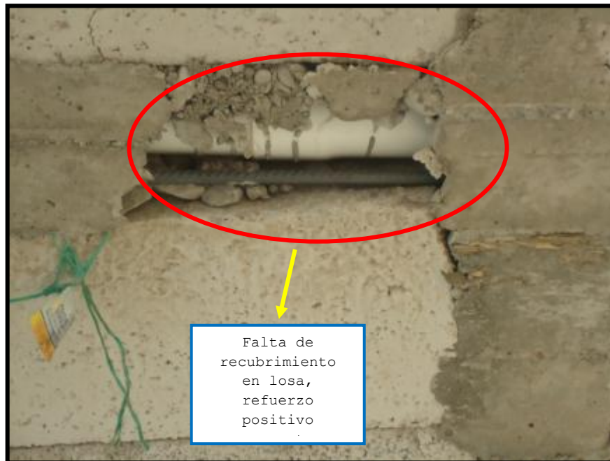
Fot. 3.19 Falta de recubrimiento en la losa (Numeral 7.7.1 literal (c) del código ACI 318-08) Fecha de captura: 13/12/2010
