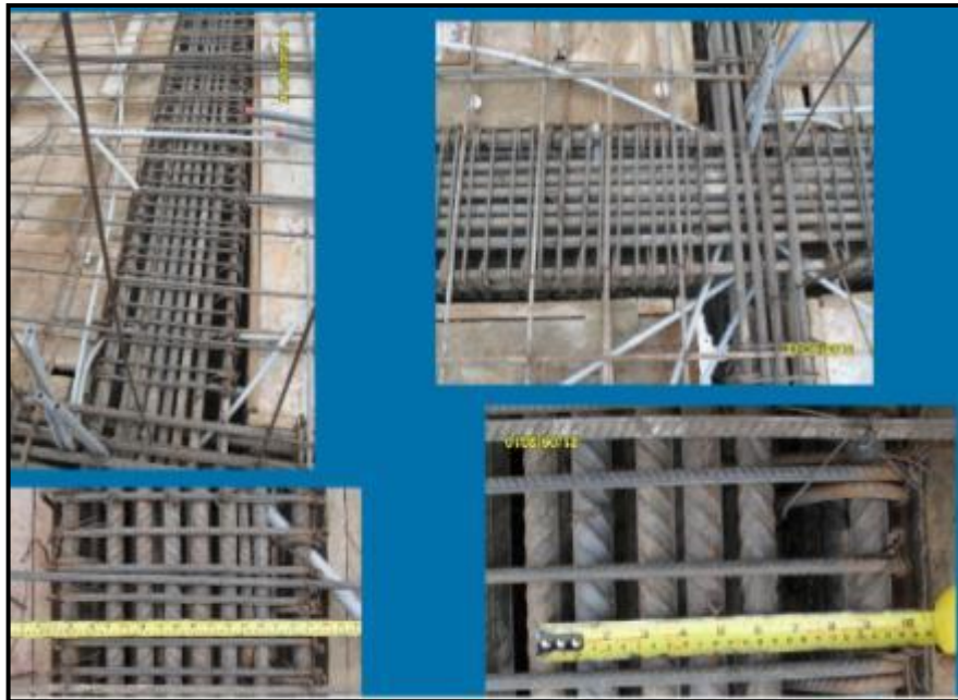
Figura 1.52 Incumplimiento de espaciamientos mínimos del acero longitudinal en vigas
