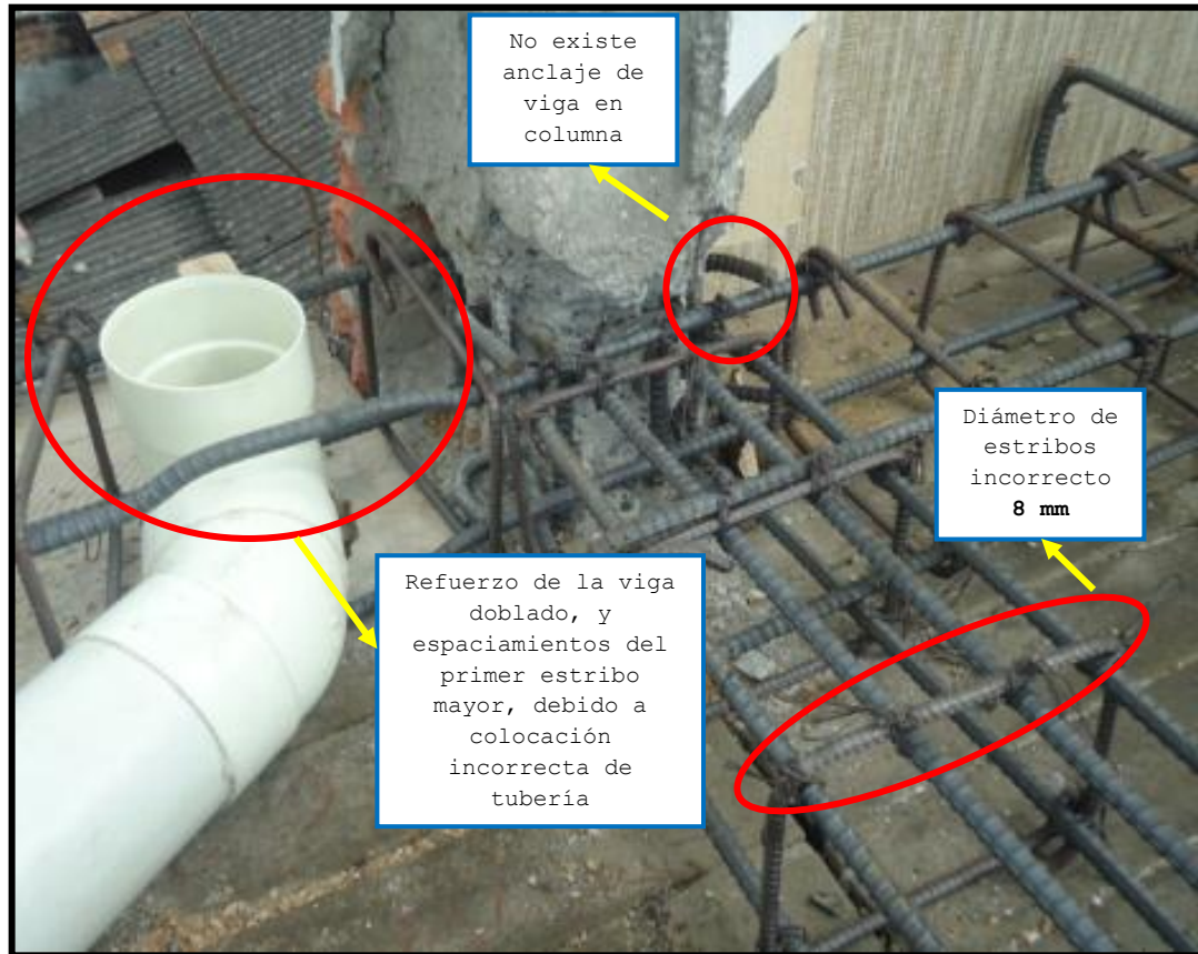
Fot. 3.28 Anclaje de viga en columna erróneo, tubería modifica la forma del acero y desplaza estribos, diámetro de estribos incorrecto, incumplimiento de: (Numeral 7.13.2.2, 21.3.42, 12.5.1, 6.3.12 y 7.10.5.1 del código ACI 318-08) Fecha de captura: 27/01/2011
