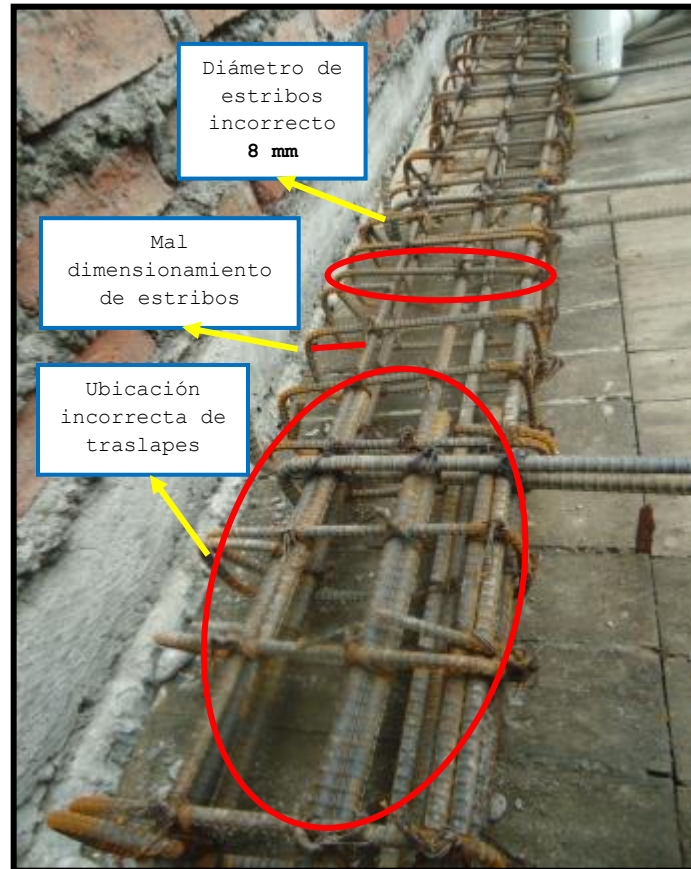
Fot. 3.48 Empalmes mismo lugar y ubicación incorrecta, mal dimensionamiento del estribo, diámetro del estribo insuficiente, incumplimiento de: (Numeral 21.5.2.3 y 7.10.5.1 del código ACI 318-08) Fecha de captura: 04/02/2011
