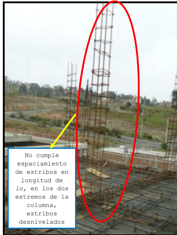
Fot.3.16 Distribución y colocación de estribos inadecuada, incumplimiento de: (Numeral 21.3.5.2 del código ACI 318-08) Fecha de captura: 01/02/2011
