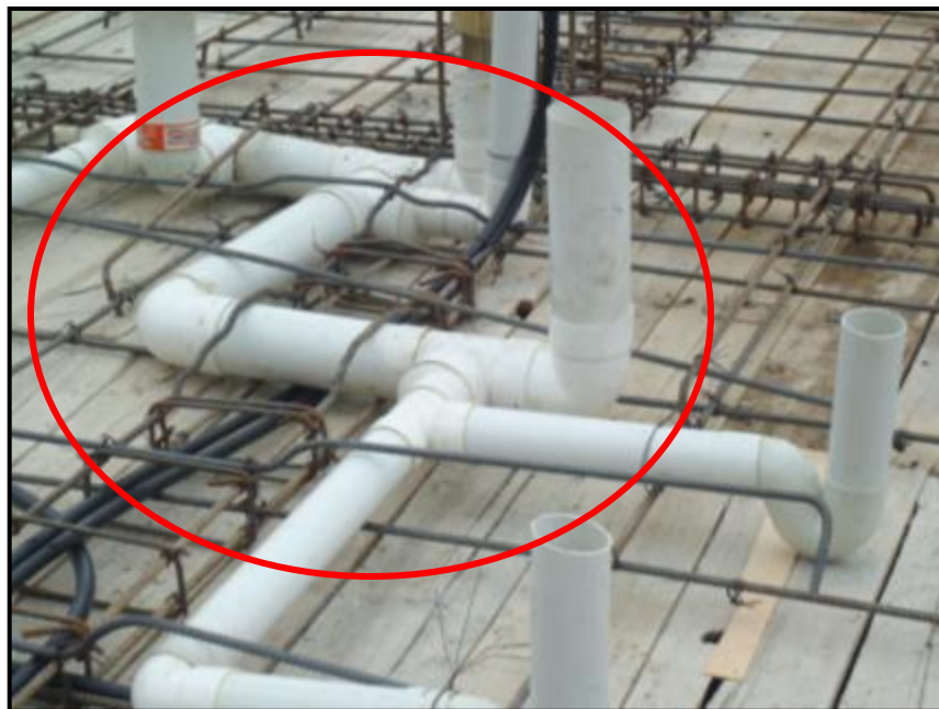
Figura 1.47 Colocación inadecuada de ductos y tuberías en vigas
