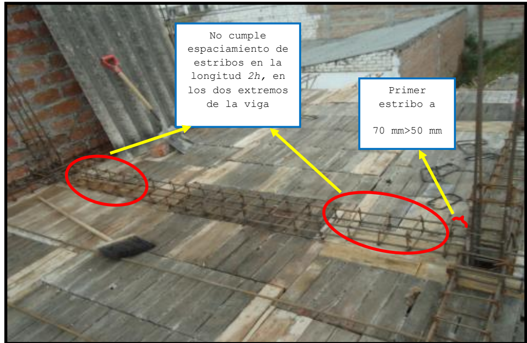
Fot. 3.3 No cumple espaciamiento del refuerzo transversal (estribos) a lo largo de la longitud de la viga, y colocación de primer estribo (Numeral 21.3.4.2 y 21.3.4.3 del código ACI 318-08) Fecha de captura: 30/11/2010
