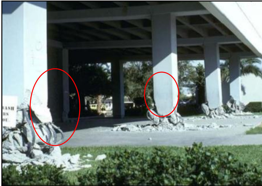
Figura 1.40 Falla de cortante en columnas por escaso refuerzo transversal
