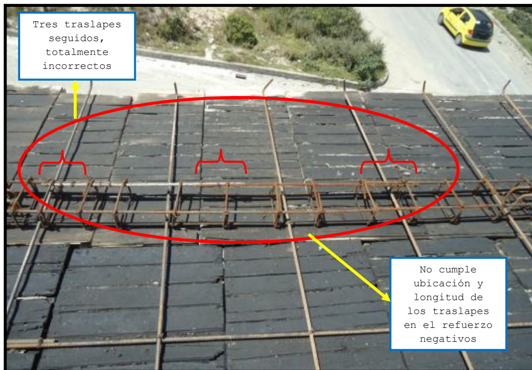
Fot. 3.7 No cumple ubicación y longitud del empalme por traslape, diámetro del estribo incorrecto (Numeral 21.5.2.3 y 7.10.5.1 del código ACI 318-08)
