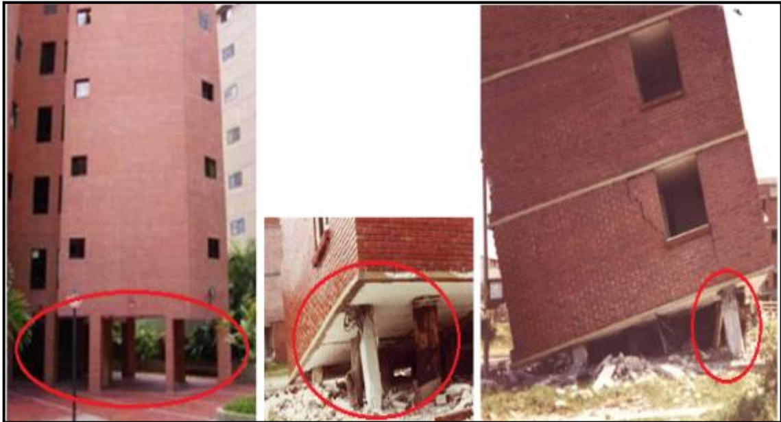
Figura 1.11 Colapso de la estructura debido a piso blando
