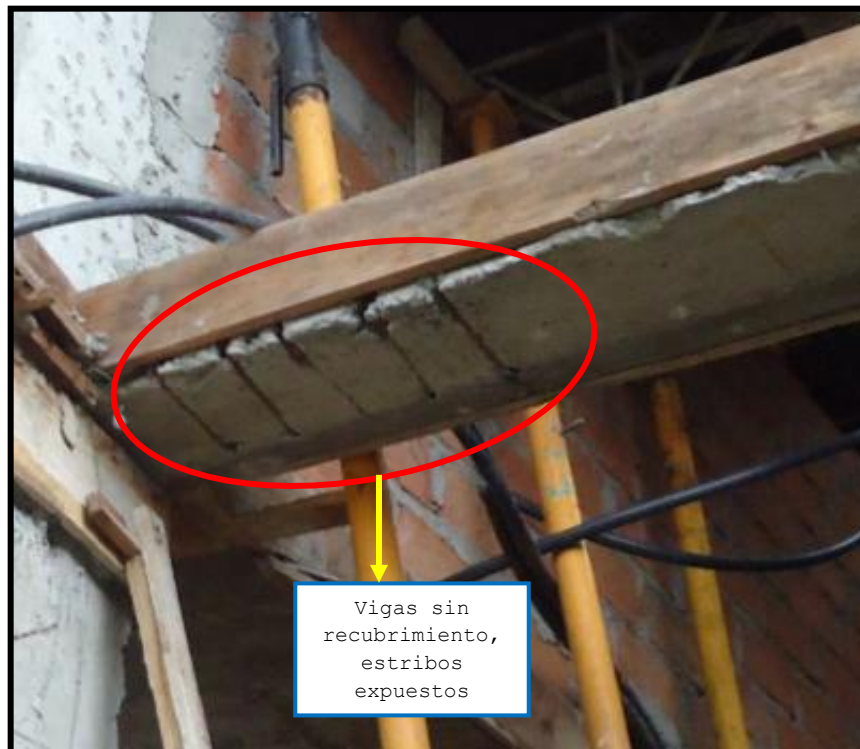
Fot. 3.22 Estribos expuestos, falta de recubrimiento en vigas, incumplimiento de: (Numeral 7.7.1 literal (c) del código ACI 318-08) Fecha de captura: 10/12/2010
