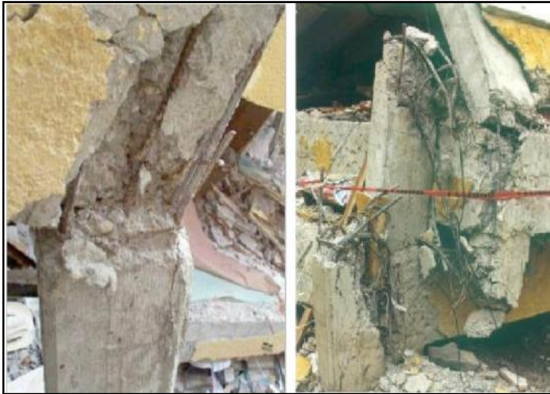
Figura 1.58 Concentraciones de traslapes, deficiente longitud de desarrollo
