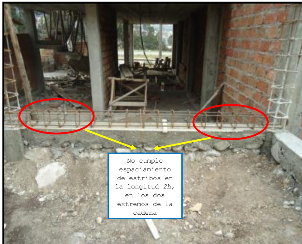
Fot.3.11 No cumple espaciamiento del refuerzo transversal (estribos) a lo largo de la cadena (Numeral 21.3.4.2 del código ACI 318-08)
