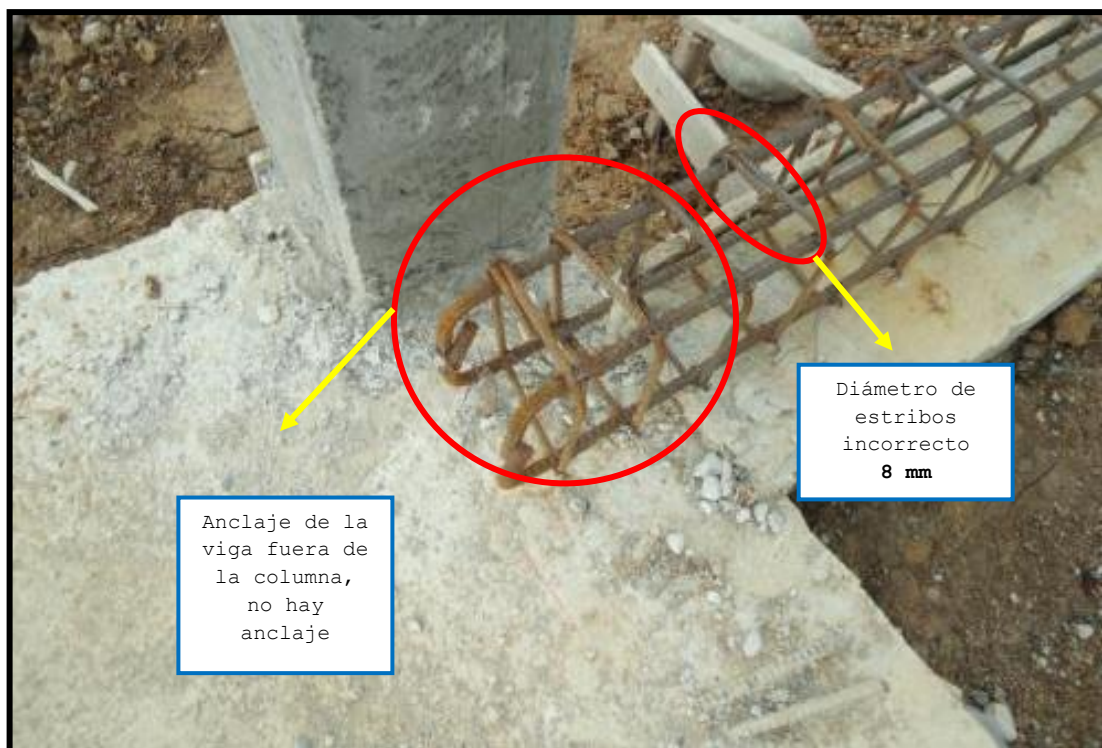
Fot. 3.20 Viga no se ancla en la columna, diámetro del estribo incorrecto, incumplimiento de: (Numeral 12.12.1 y 7.10.5.1 del código ACI 318-08)
