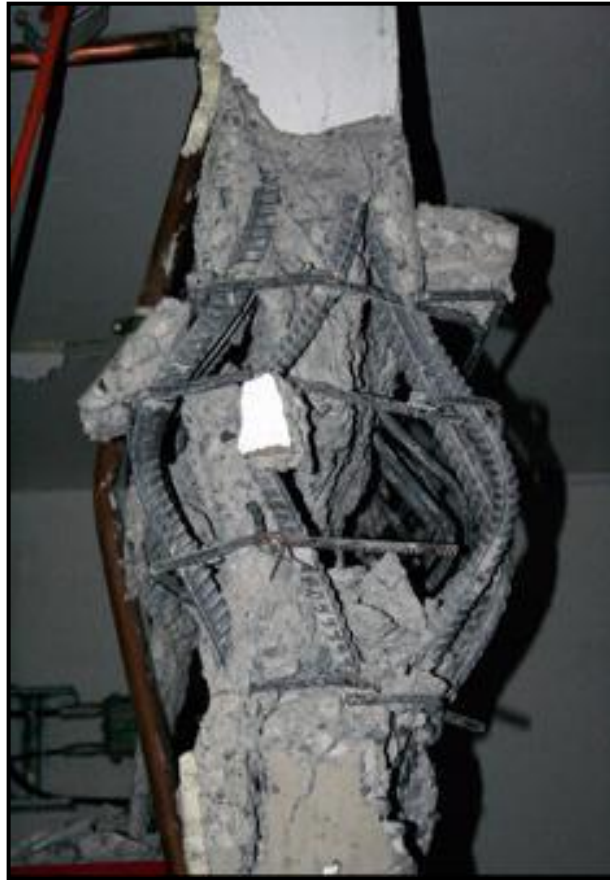
Figura 1.46 Falla en columna por colocación de estribos con ganchos a 90°
