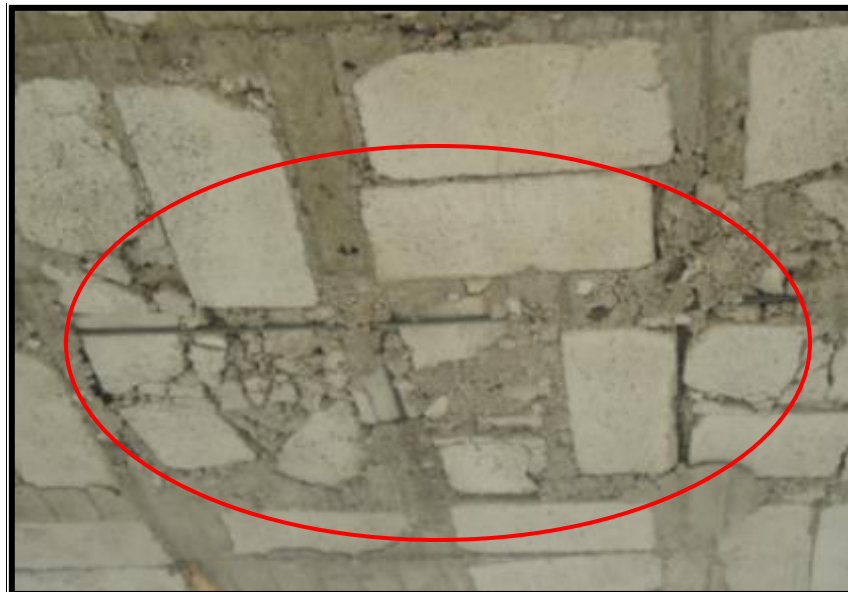
Figura 1.51 Falta de recubrimiento en losas
