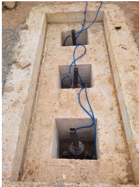
c. Vista general de la conexión de tubería a los cilindros.
