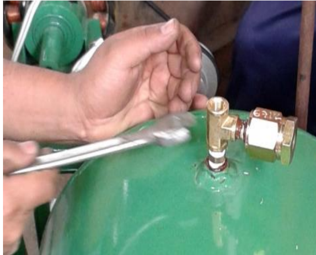
Figura 3.9. Instalación de la válvula check para la entrada de aire al tanque. Fotografía de los autores.
