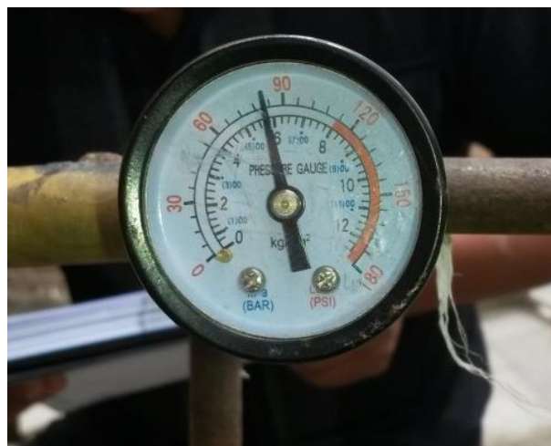
Figura 4.2. Manómetro instalado en el tanque del sistema, empleado en las diversas pruebas de desempeño. Fotografía de los autores
