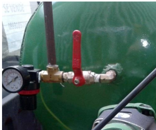
Figura 3.10. Válvula manual y regulador de presión, colocados a la salida de aire del tanque. Fotografía de los autores.
