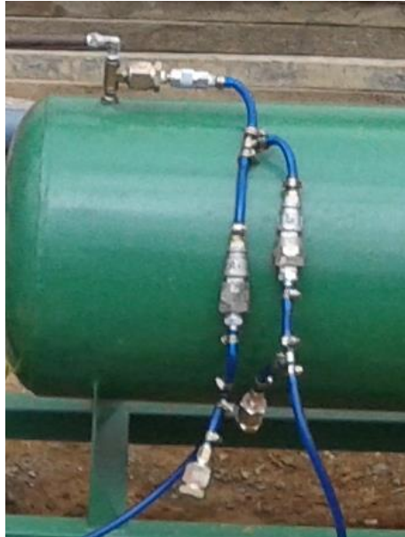
Figura 3.27. Conexión de la tubería a los cilindros. Fotografía de los autores.
