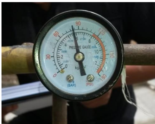
Fig. 27. Manómetro instalado en el tanque del sistema, empleado en las diversas pruebas de desempeño. Fotografía de los autores
