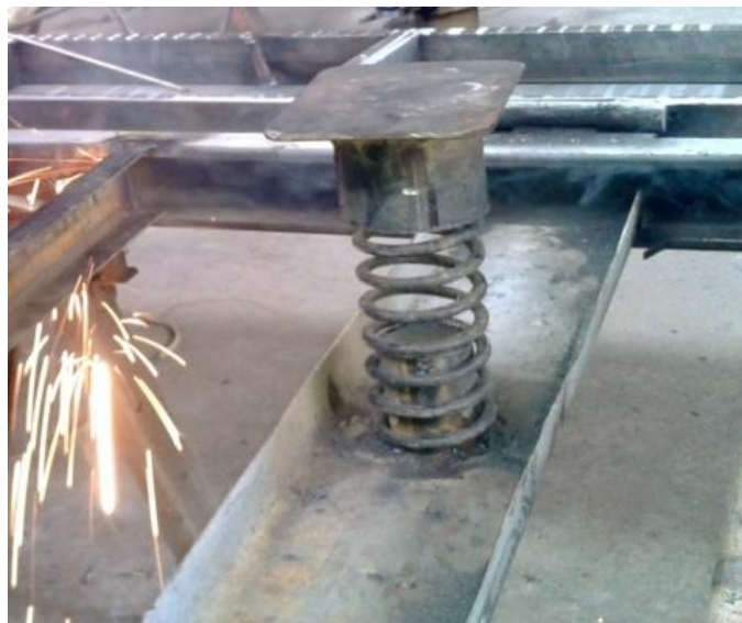
Figura 3.4. Colocación de los muelles en la plataforma, con su soporte base y acople en la parte superior. Fotografía de los autores.
