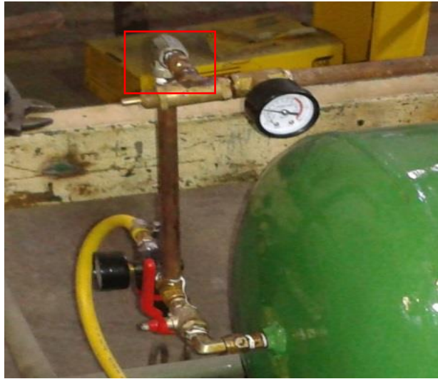
Figura 3.11. Válvula de alivio y manómetro. Fotografía de los autores.
