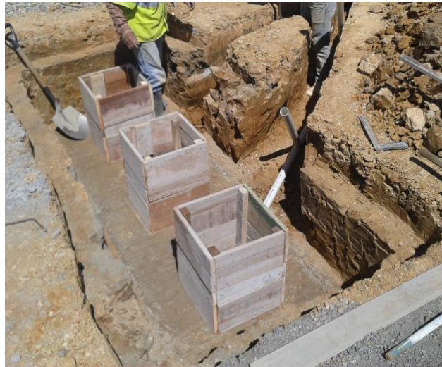
c. Colocación de encofrado para la fundición de las cámaras de los cilindros.
