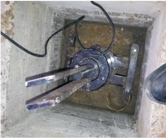
b. Cilindros emperrados en la superficie de la obra civil.
