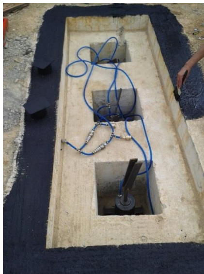
Figura 3.29. Pintado de los perfiles de la obra civil requerida. Fotografía de los autores.
