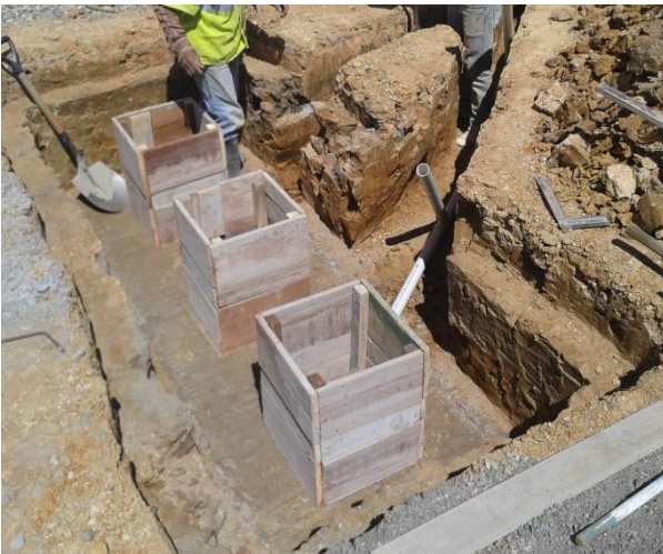
c. Colocación de encofrado para la fundición de las cámaras de los cilindros.
