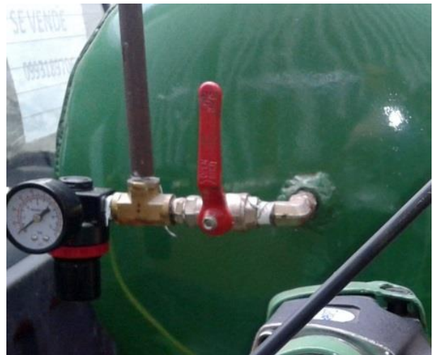
Fig. 10. Válvula manual y regulador de presión, colocados a la salida de aire del tanque. Fotografía de los autores.
