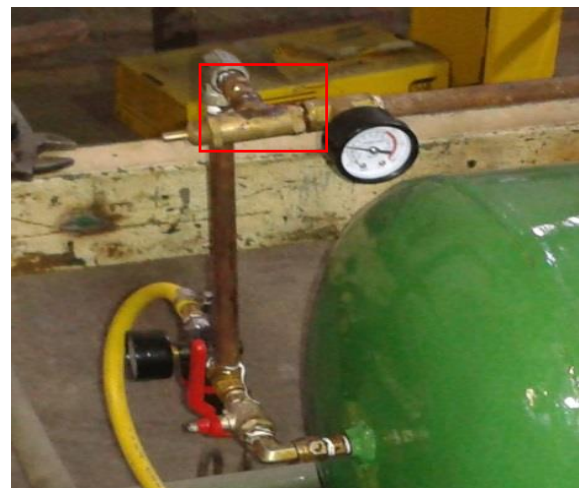
Fig. 11. Válvula de alivio y manómetro. Fotografía de los autores.
