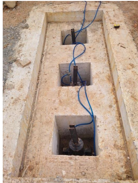
Fig. 21. Vista general de la conexión de tubería a los cilindros. Fotografías de los autores.
