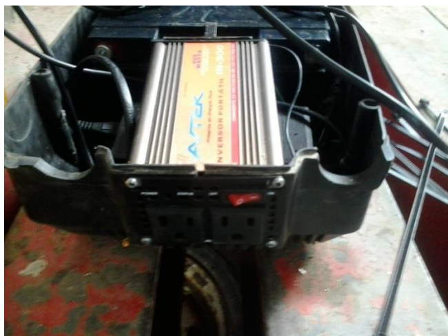
Fig. 12. Ubicación de la interface del inversor en el cuerpo. Fotografía de los autores
