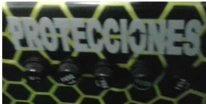
Figura 4.3 Fusibles de protección a los equipos. Fuente: fotografía de los autores.
