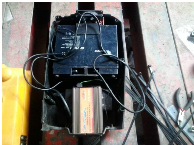
Fig. 11. Ubicación de la batería y del inversor en la base del cuerpo. Fotografía de los autores
