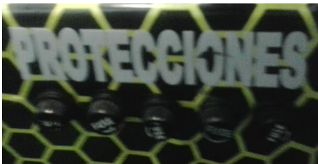
Fig. 17. Fusibles de protección a los equipos. Fotografía de los autores
