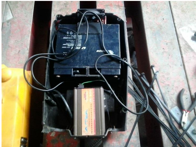
Figura 3.10 Ubicación de la batería y del inversor en la base del cuerpo. Fuente: fotografía de los autores.
