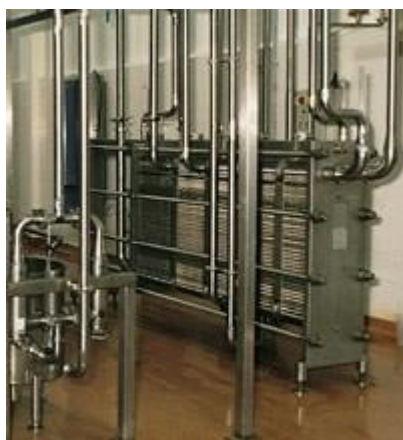
Intercambiador de calor sistema UHT
