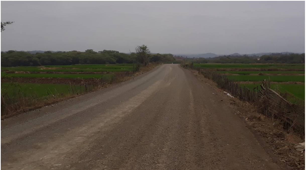
Figura 10. Estado actual de la Vía, sector La Ceiba.
