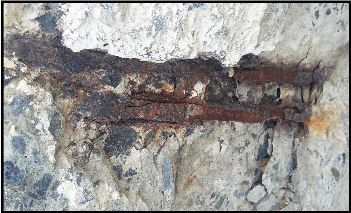
Figura 1: La formación de etringita ha provocado la destrucción del recubrimiento del hormigón.
