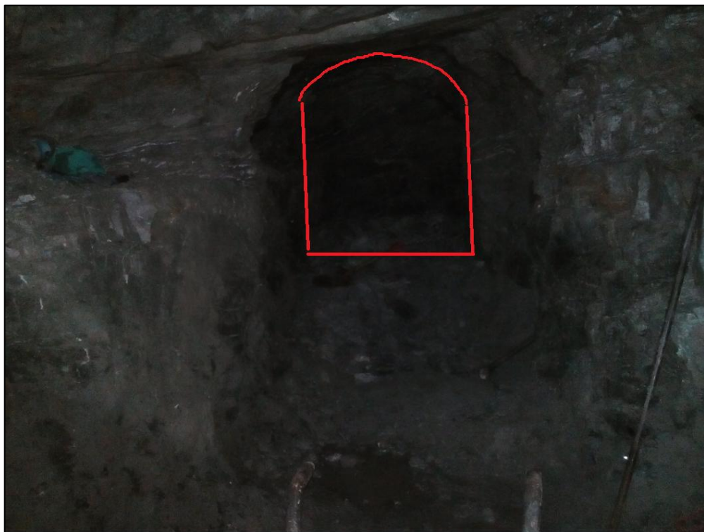
Figura 16. Sección final del frente en galería de desarrollo. Fuente: El autor. Elaboración: El autor.
