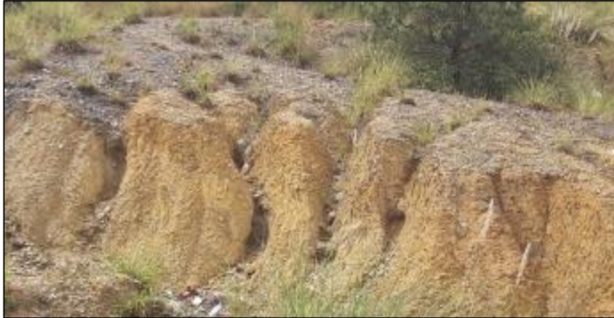
Ilustración 33. Estructuras de dispersión gullies, sector Yahuaracuna.
