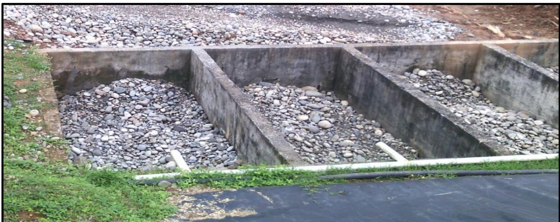
Figura 16: Tanques sedimentadores de lixiviados.
