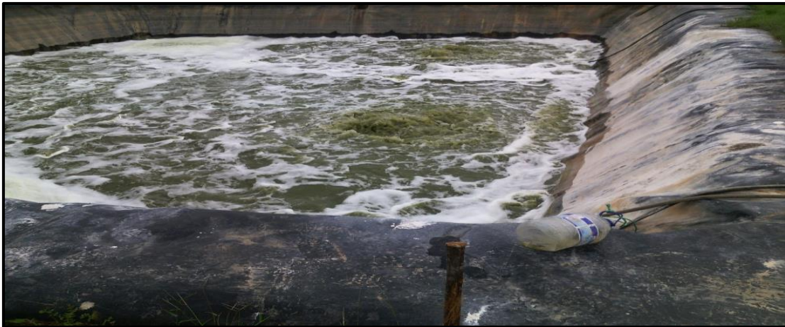
Figura 15: Piscina de lixiviados de pretratamiento.
