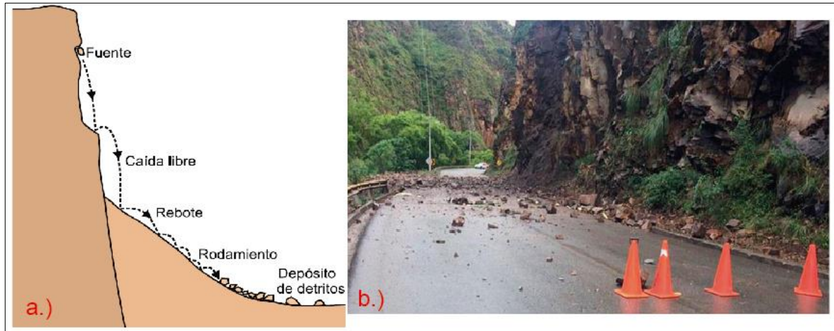
Figura 5: Caída de roca. a.) Caída de cantos y bloques; b.) Caída de rocas en la vía "El Descanso-Paute", Azuay, Ecuador.
