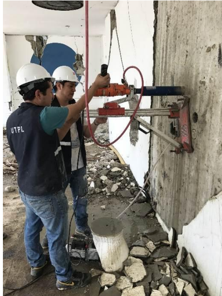
Fotografía 3. 5. Extractor de núcleos de 4 pulgadas. Fuente: El Autor. Elaboración: El Autor.
