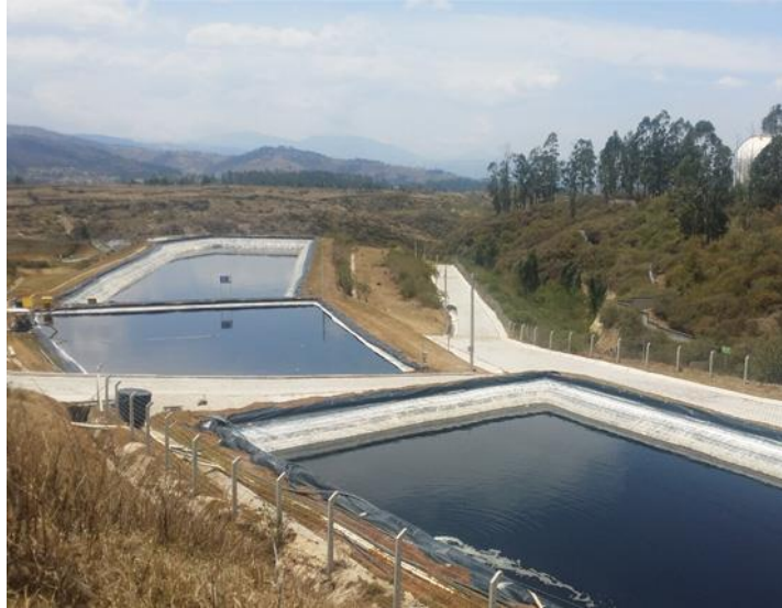
Imagen 17. Piscina de tratamiento de lixiviados Fuente: Pagina web de EMGIRS 2014 Elaborado por: Emgirs
