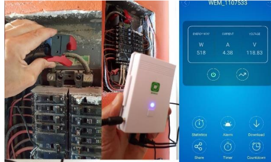
Figura 2. Medidor Wemeter conectado a tablero eléctrico Fuente: (Wemeter, 2017) Elaboración: (Wemeter, 2017)
