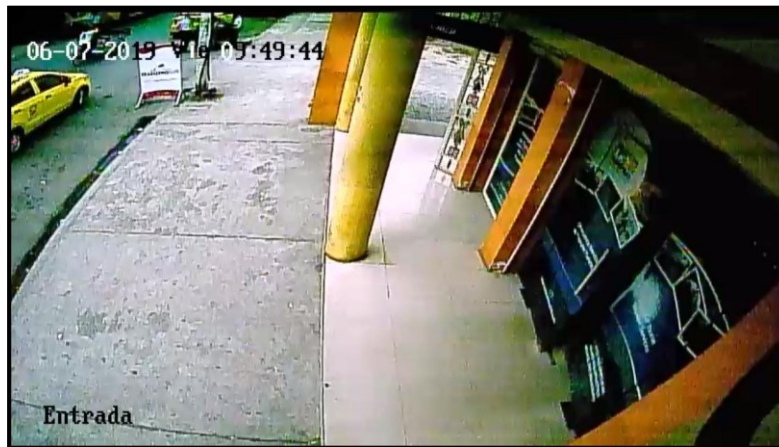
Figura 34. CÁMARA 1 EN FUNCIONAMIENTO Fuente: Transfrosur Cía. Ltda. Elaboración: Fabián Farfán
